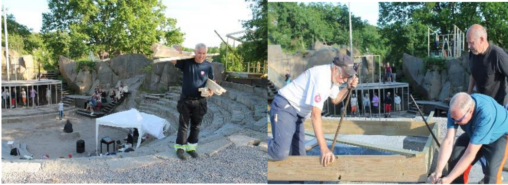
Full innsats både med prøver i Brottet og på ulike prosjekter. Ikke en helt uvanlig situasjon. Her Helge Olav Lilleheier, Bjørn Hoff, Willy Mølberg og Thor-Ivar Olsen i ferd med å bygge lystårn.
