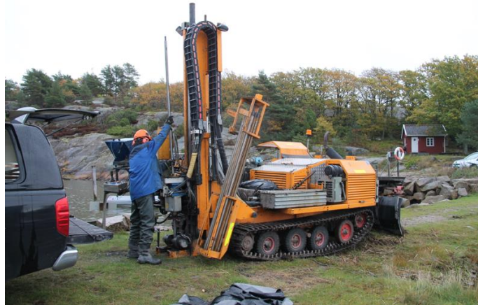
Boring for undersøkelser av løsmasser og avstand til fjell ved Petter Olsen AS i 2013
